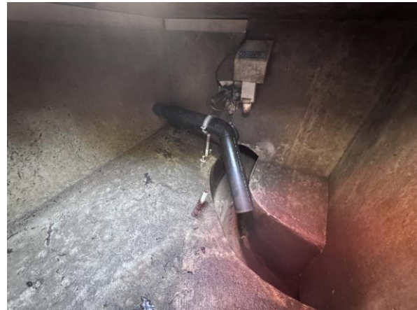
Abbildung 12: Messschacht mit Druckleitung und Durchflussmessung für Schieber
